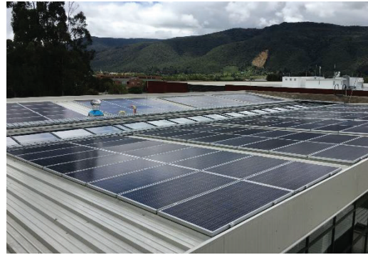
Fotografía 6. Paneles solares sobre la cubierta del edificio.
